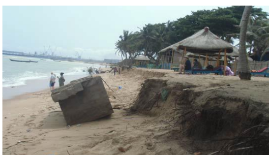
Photo 1.2 : Destruction des infrastructures de l'hôtel Coco Beach
